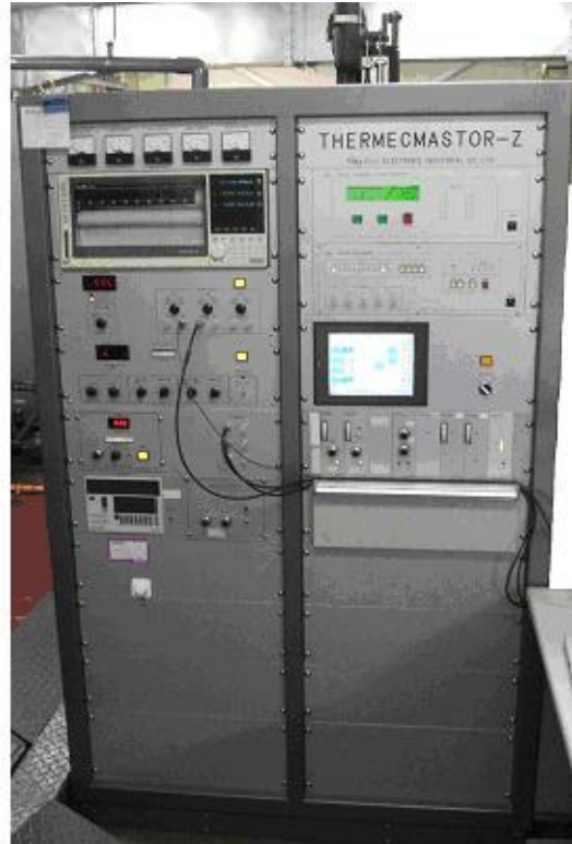
制御操作盤本体
